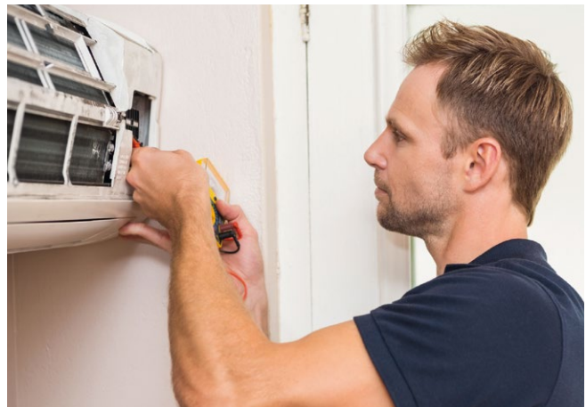
Der Unterhalt der Klimaanlage ist ebensowichtig wie die richtige Planung.
